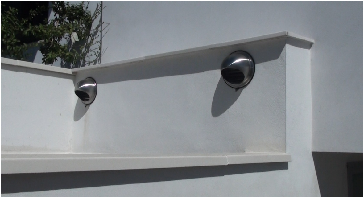
Toma de aire limpio exterior de la vivienda y respiradero del sotano
