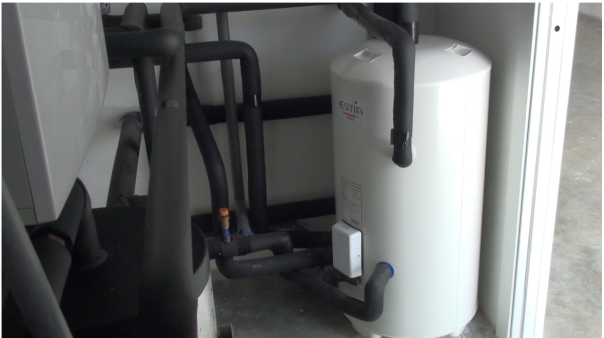
Deposito de Agua Caliente Sanitaria (ACS) con conexionado a recirculación
