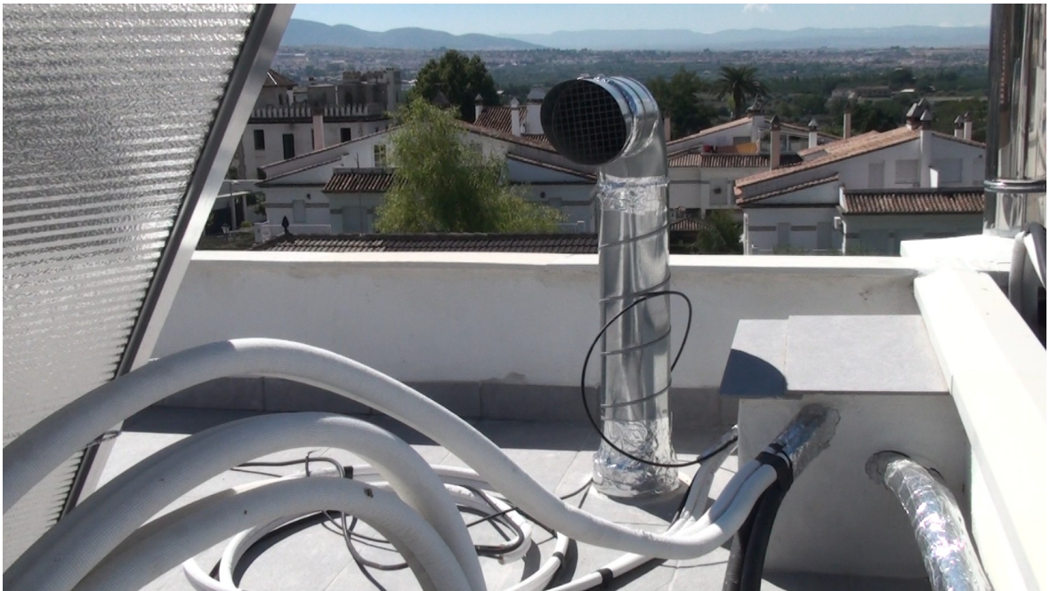
Tubo de extracción de aire viciado en cubierta superior
