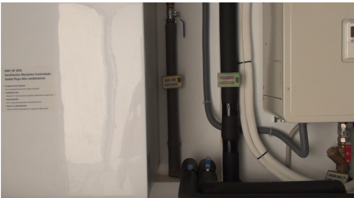
Ida y retorno de agua hacia las placas solares en azotea, debidamente aisladas
