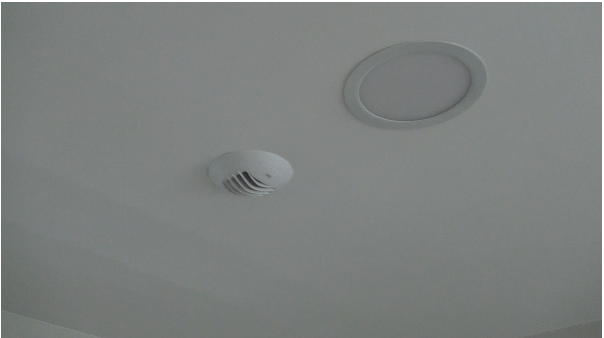
Boca de extraccion de aire viciado junto a una luminaria LED en techo
