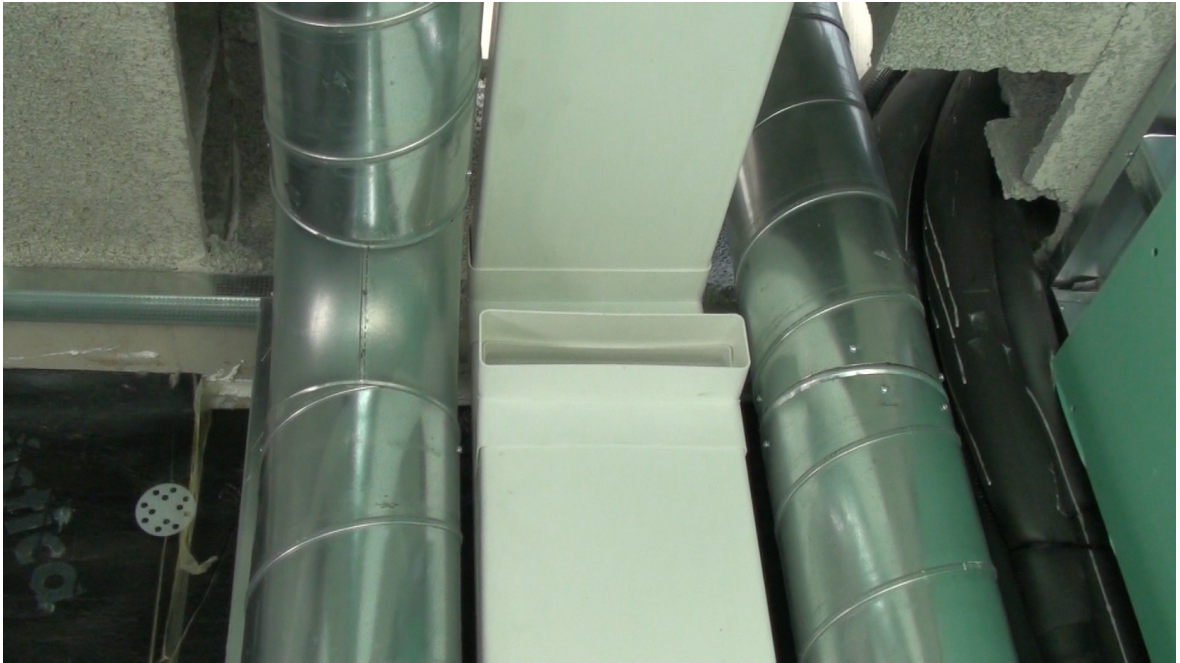
Paso de los tubos generales de insuflación, extracción, y reparto de aire
