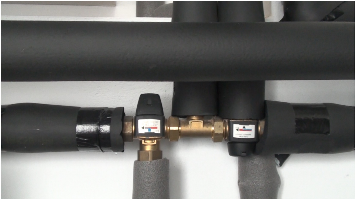
Valvulas termoestaticas mezcladora y selectora para derivar a consumo o a deposito ACS
