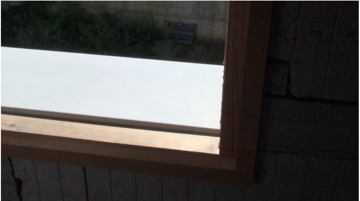
Remate del alfeizar de ventana con piedra de hormigón polímero
