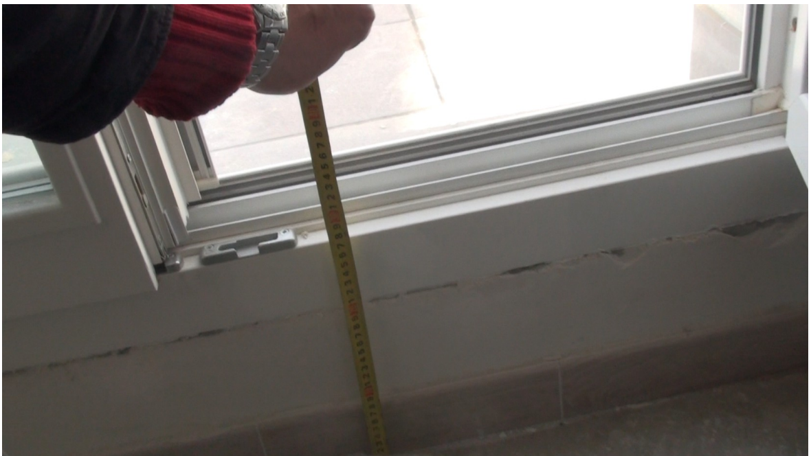
Diferencia de altura en suelos de puerta debido al aislamiento de cubierta en ultima planta
