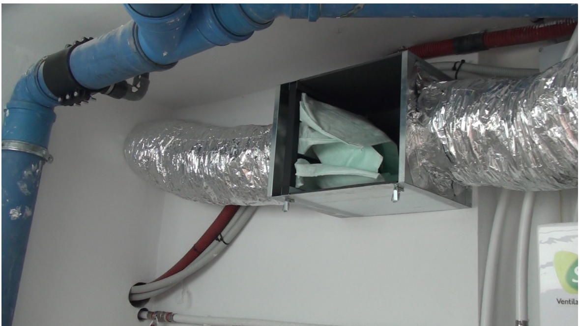
Caja de filtrado general del aire que ingresa a la vivienda
