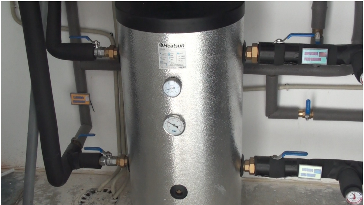
Deposito de inercia del suelo radiante
