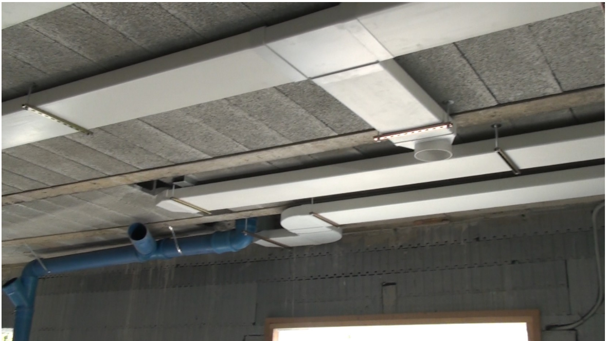
Red de distribución y extracción de aire hacia/desde las habitaciones
