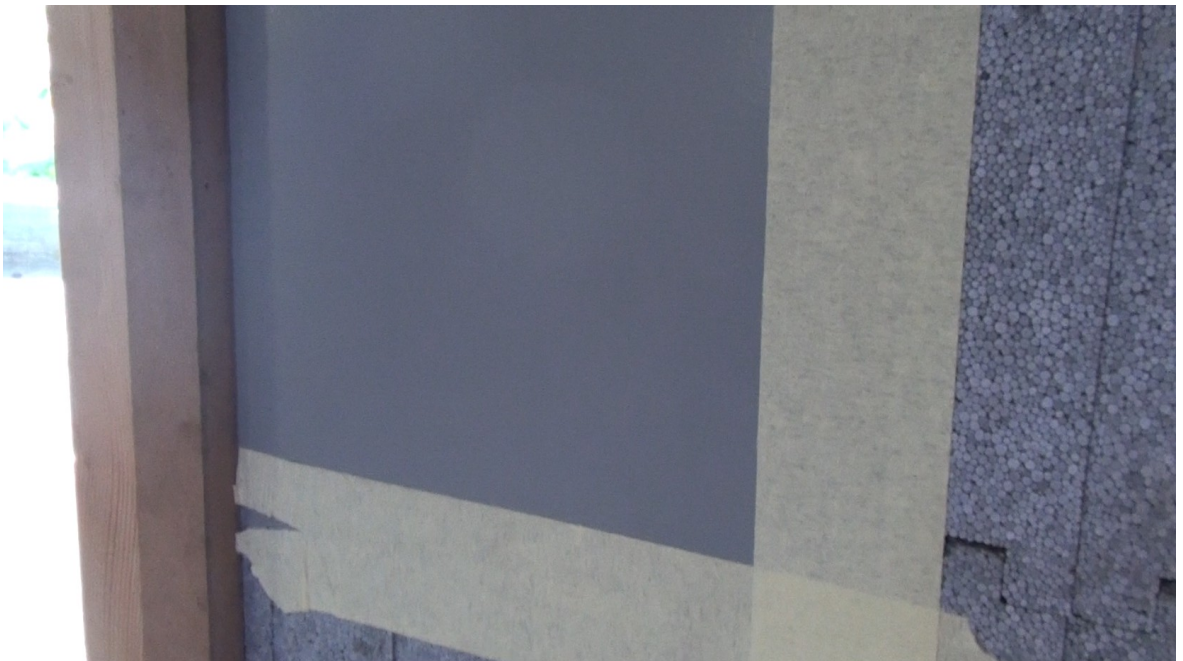
Sellado y aplicación de aislamiento inyectado de poliuretano en puntos de amarre
