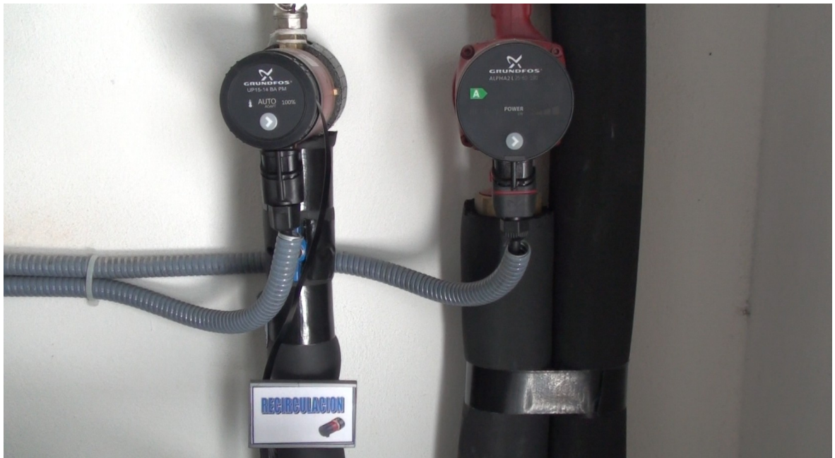
Bombas de alta eficiencia para la impulsión del suelo radiante y recirculación de ACS
