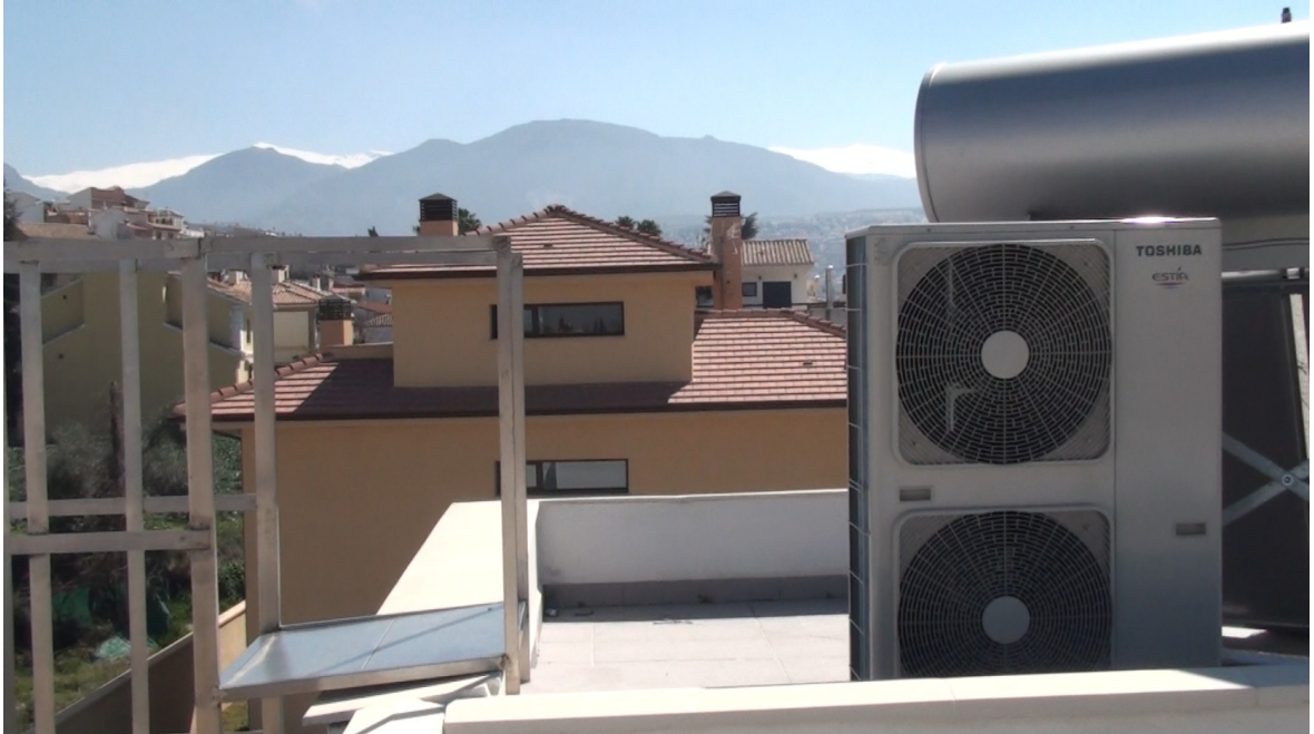
Unidad exterior de la bomba de calor del sistema Estia
