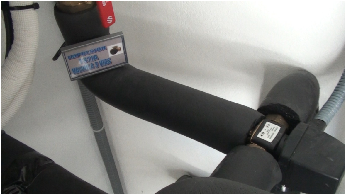
Válvula de 3 vías que selecciona el circuito a calentar entre ACS y Suelo Radiante
