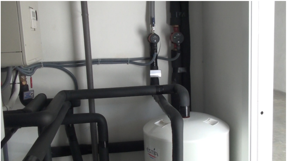
Arriba a la derecha, bombas de recirculación de ACS e impulsión de suelo radiante
