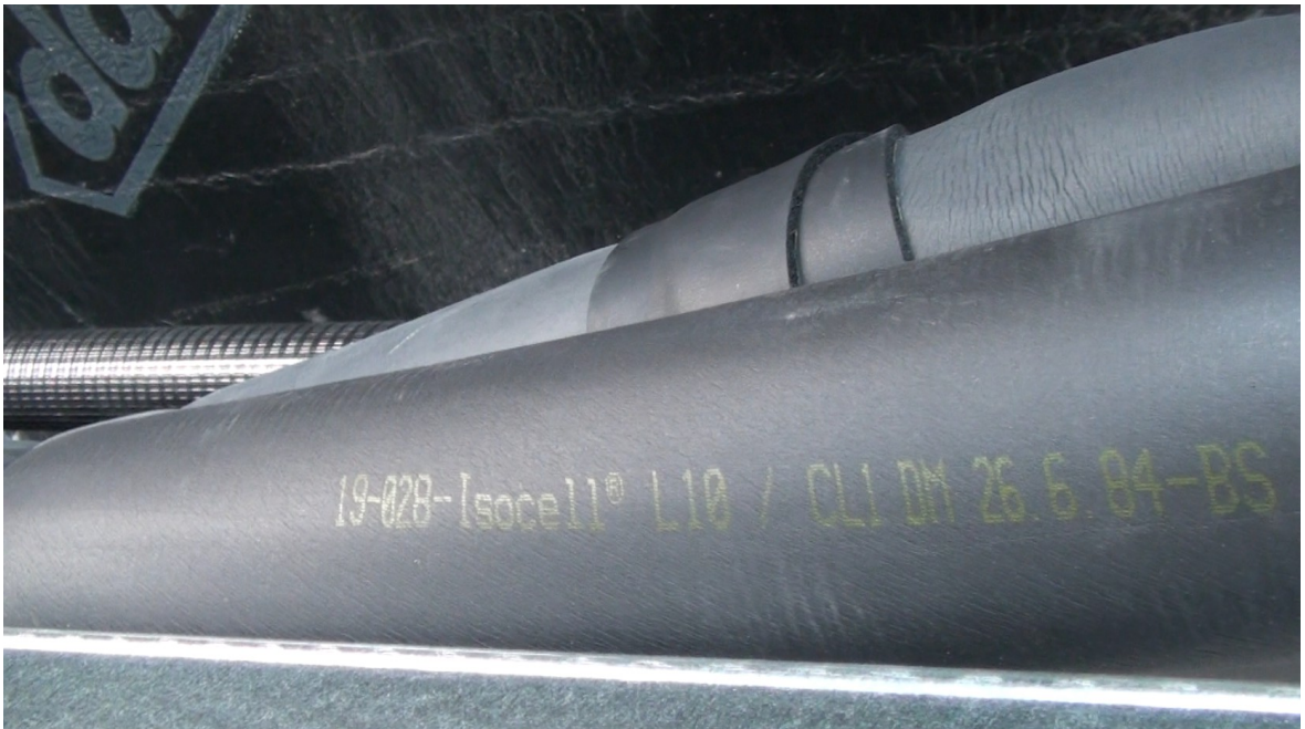
Calorifugado mediante recubrimiento con coquilla aislante de todas las tuberías
