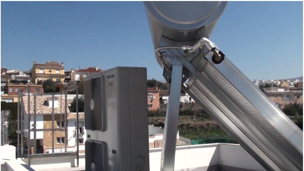
Instalaciones en azotea, sobre la cubierta plana del torreón de ultima planta
