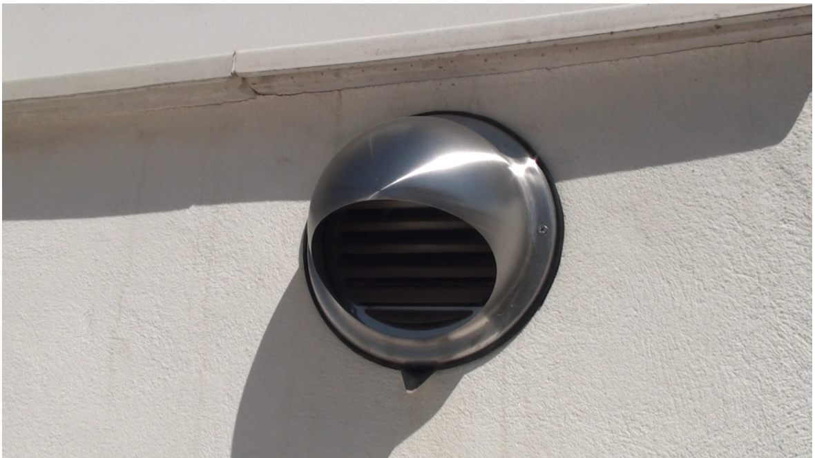
Detalle de boca de toma de aire limpio hacia el interior de la vivienda
