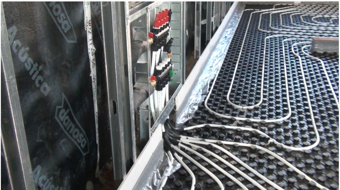
Sistema de calefacción a baja temperatura por suelo radiante de la marca Uponor
