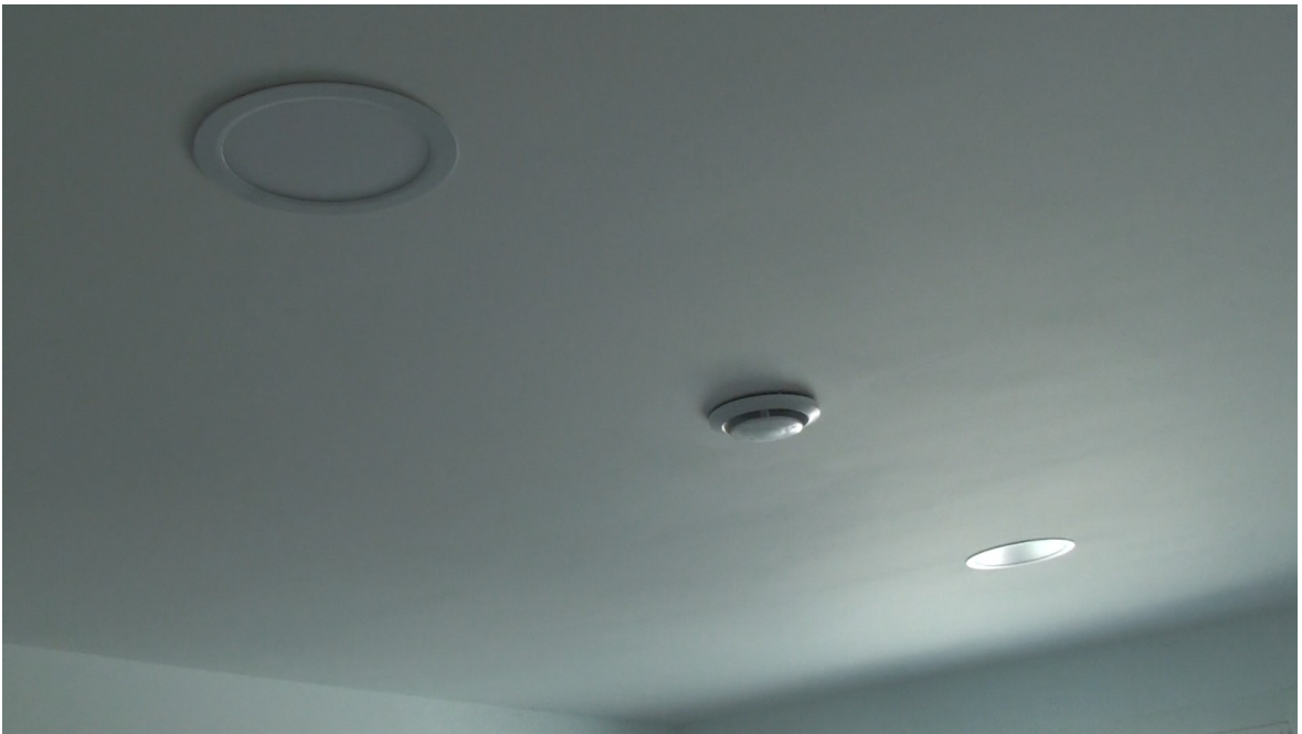
Boca de insuflacion de aire renovado junto a dos luminarias LED de bajo consumo
