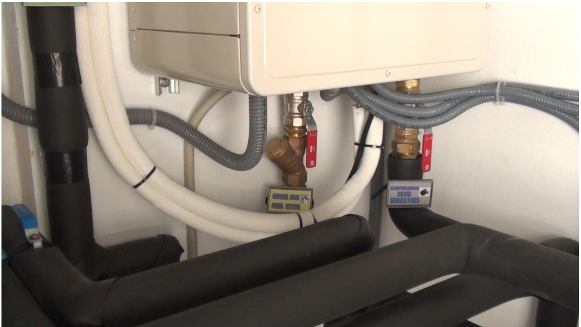
Interconexión del intercambiador de placas de la Estía
